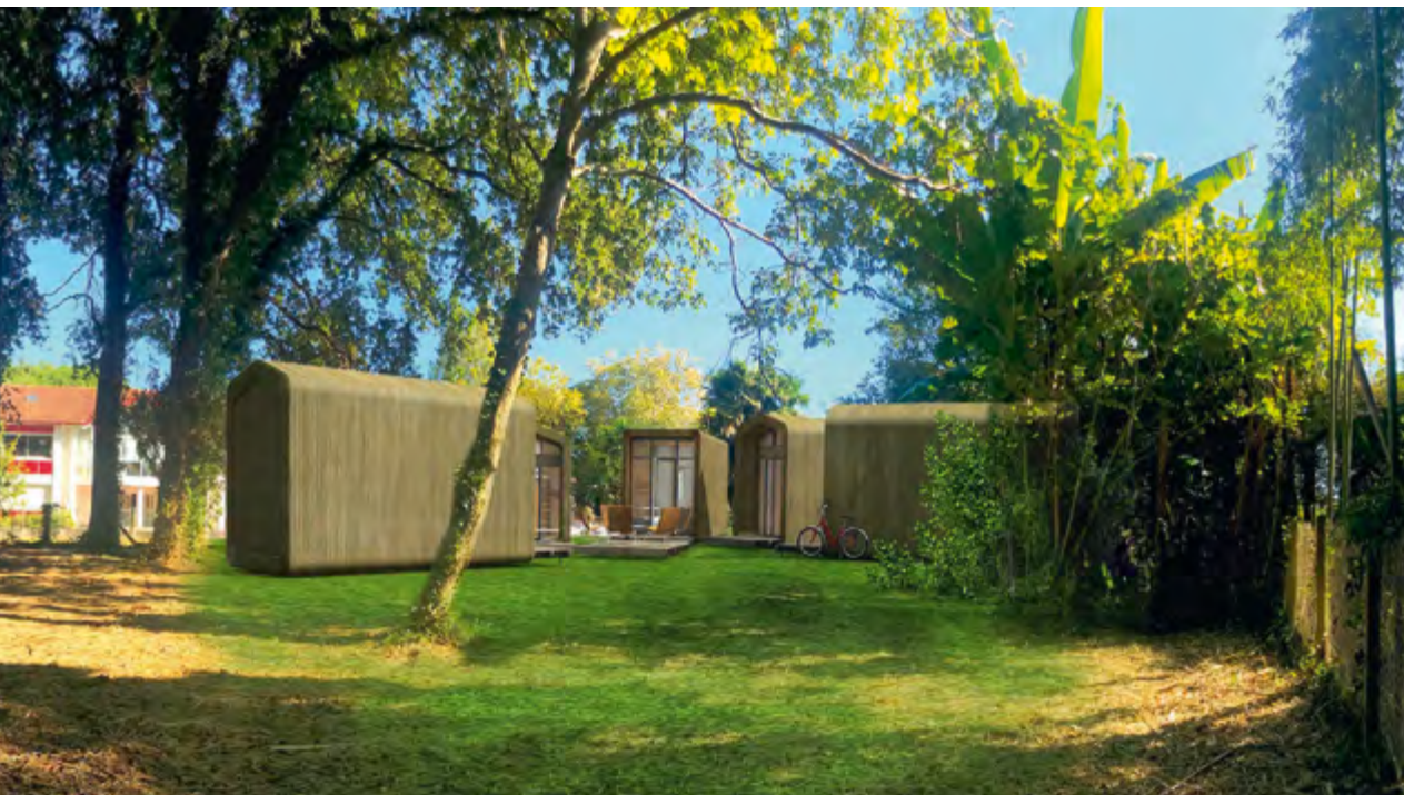
« Mugi », le village d'habitat déplaçable pour les saisonniers, est en cours de construction. © Inaki Noblia
