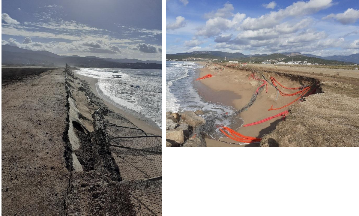
Figure 2 : talus aéroportuaire après les tempêtes de 2023.
