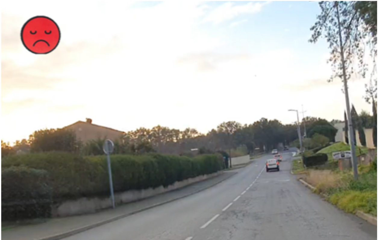
Chaussée trop large, favorisant les vitesses excessives
