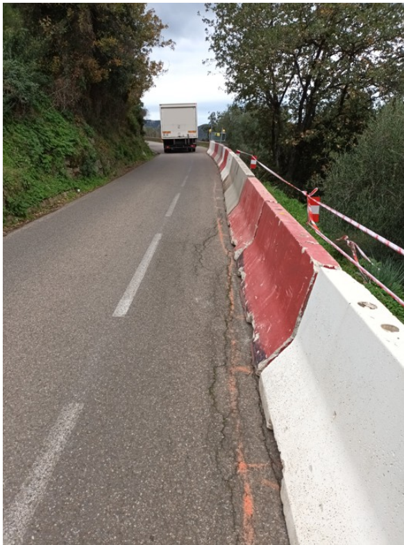
Figure 7 : fissuration vue vers l'Ouest
