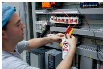
Consignation dans un local technique pour intervention de maintenance électrique
