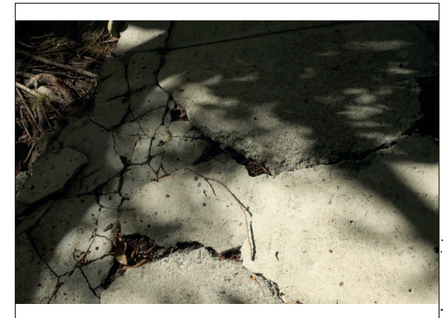
Fissures provoquées par les racines
