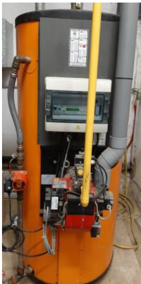
Ballon de stockage d'ECS
