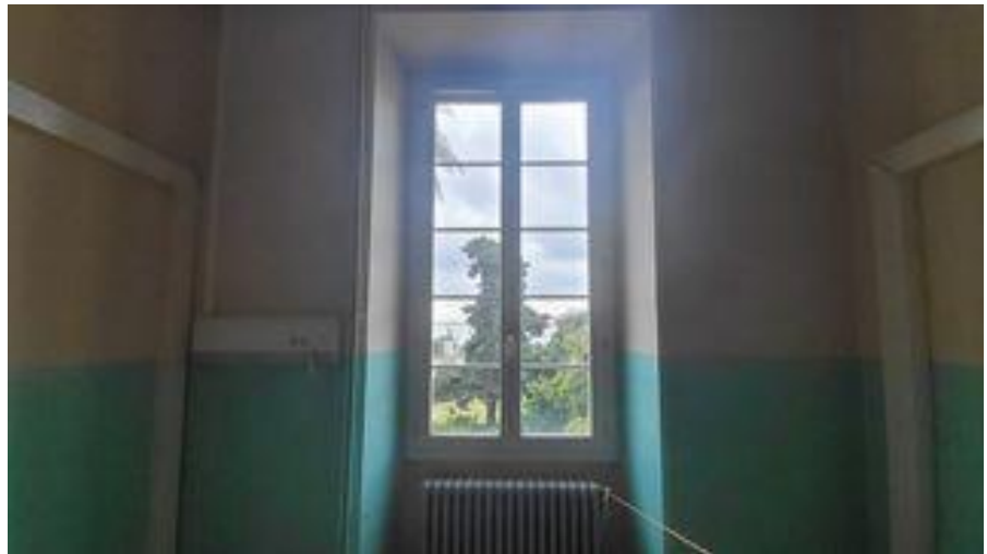
Illustration 30 : Les menuiseries extérieures PVC
