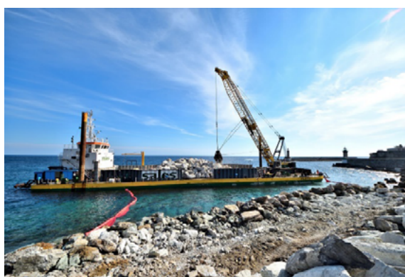
Port de Bastia : travaux de confortement du talus de protection du quai des Martyrs
