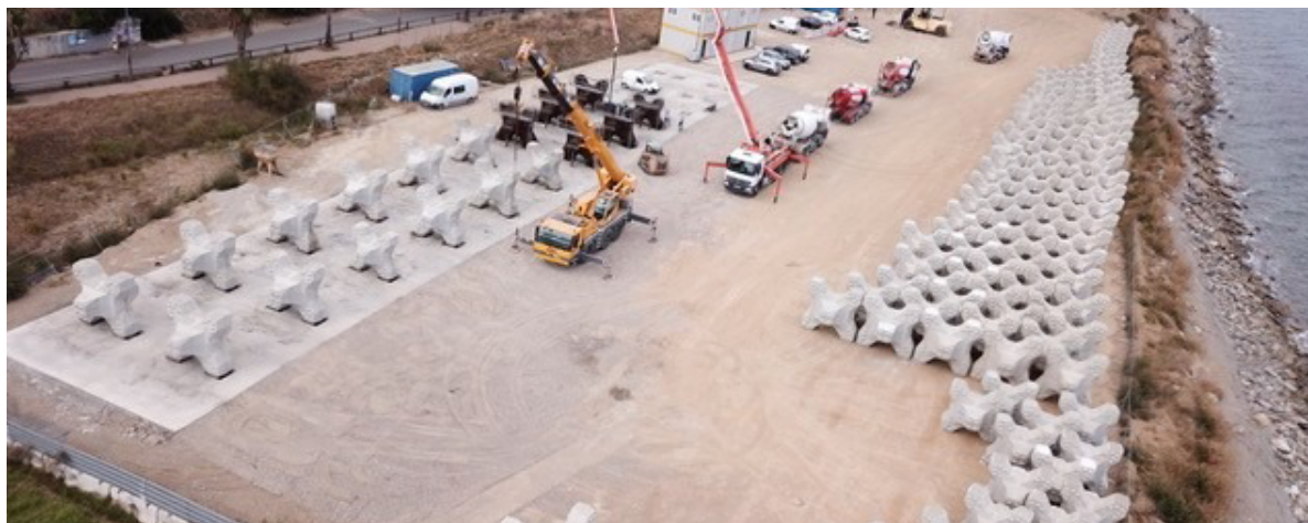
Arinella, aire de préfabrication des Acropodes II TM pour le futur renforcement des jetées du vieux port de Bastia
