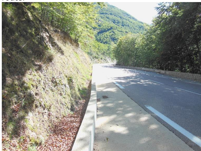
FIGURE 5 : CUNETTE BETONNEE ACTUELLEMENT EN PLACE
