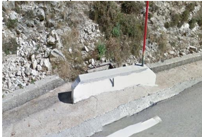
FIGURE 6 : PUISARD RELIE A UN COLLECTEUR ENTERRE
