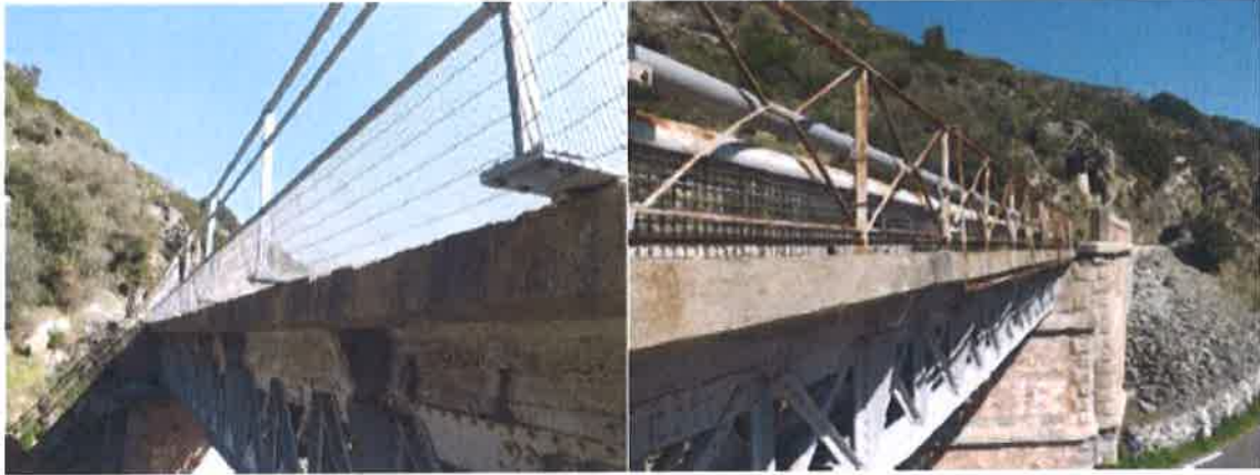
Garde-corps à remplacer (Albano)
