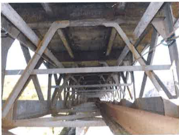
Protection anti-corrosion à prévoir sous tablier (Asco)
