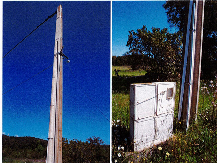
Figure 11 : pylône et coffret électrique abritant le compteur.
