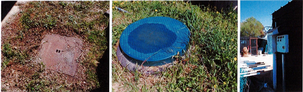
Figure 10 : regard du réseaux d'eaux usées, station de relevage et son coffret de contrôle électrique.
