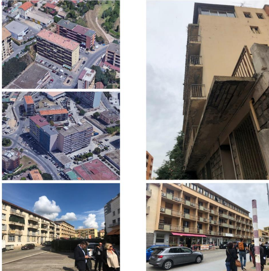
Figure 16 : Des copropriétés et immeubles dégradés, sources de nuisances pour les habitants et l'attractivité du quartier
