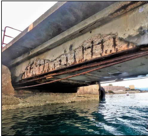
Etat d'un élément de travées
