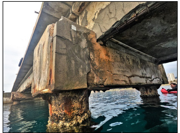
Etat d'un appui
