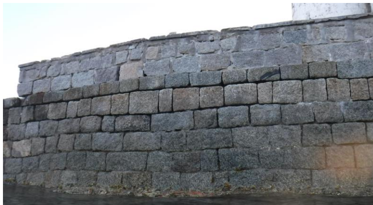
Disjointment en parement sur la jetée de Scoglio Longo
