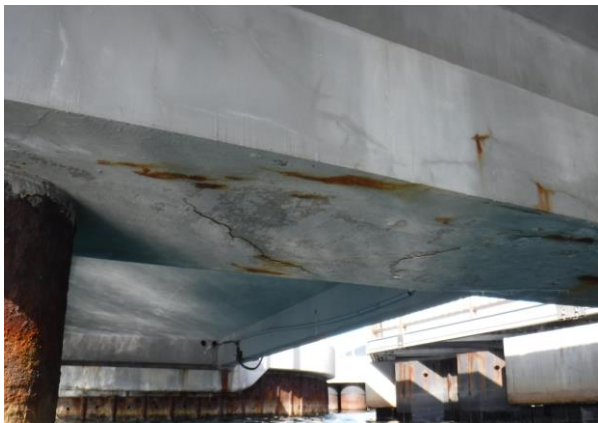
Poste N°1 – Fissuration du revêtement et traces de corrosion. Eclatement du béton à craindre sur ces zones (passerelle N°3)
