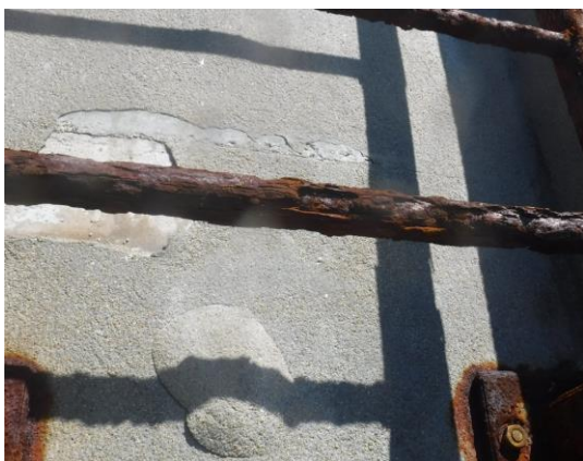
Corrosion avancée des barreaux
