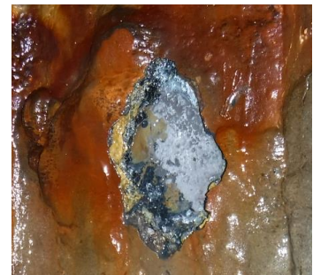
Pastille de mesures sur zone corrodée à l'intérieur du duc d'Albe du poste N°3
