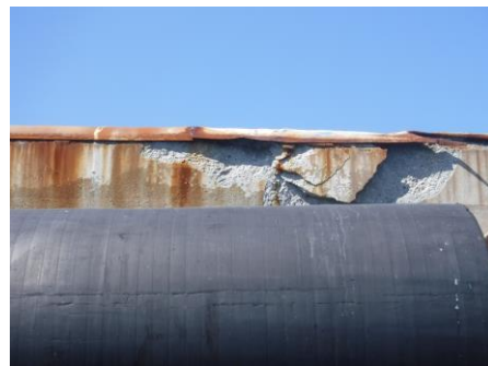
Eclat en partie supérieure du couronnement (choc) de la plateforme d'embarquement du poste N°3
