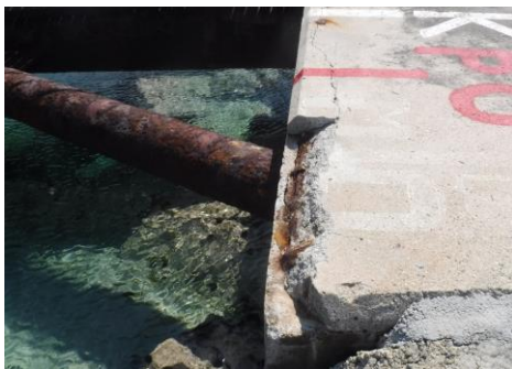
Eclats sur arête au niveau de la plateforme béton de la digue du large, servant d'ancrage au pieu supportant la passerelle lamaneur (béton pollué)
