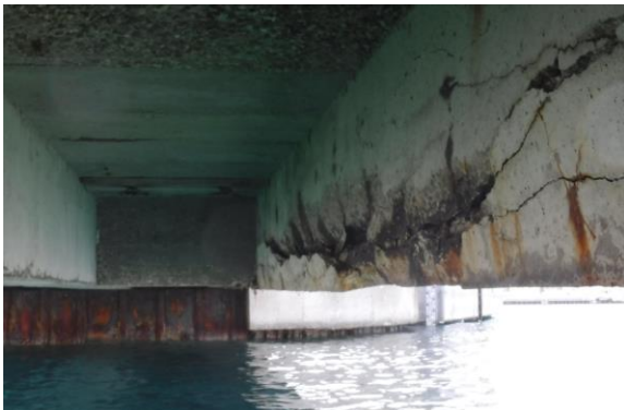
Désordres observés sur la retombée de poutre côté Sud
