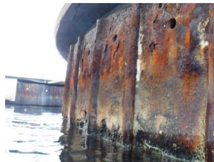
Mesures de contrôle à prévoir à moyen terme sur structures métalliques du poste de la ville
