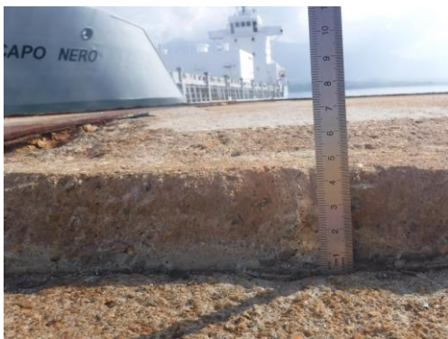
Mesure du rejet vertical à l'arrière du couronnement (plateforme d'embarquement du quai de la jetée)
