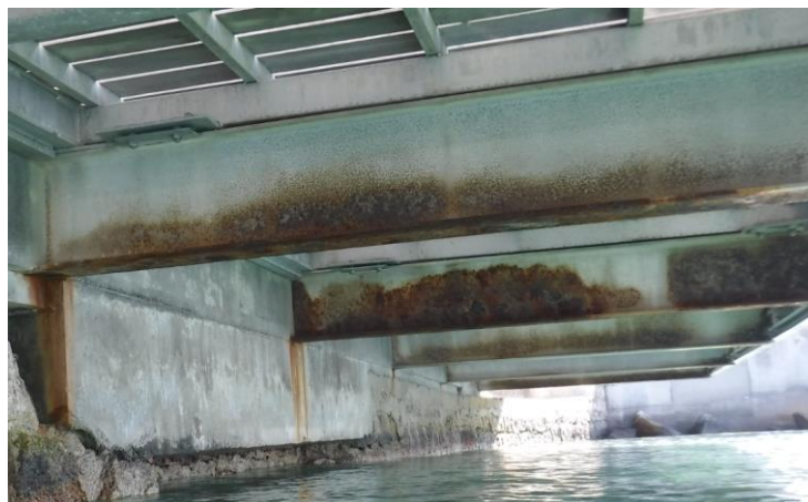
Corrosion plus ou moins accentuée des 7 IPE supports
