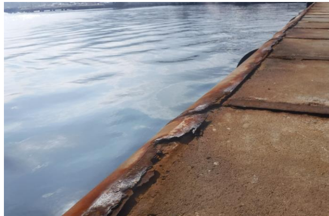
Quart de rond détérioré sur nez de quai (plateforme du quai de la jetée)
