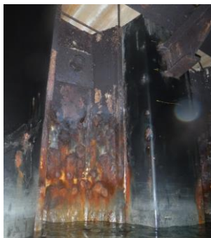
Zone à contrôler à l'intérieur du duc d'Albe du quai de la jétée
