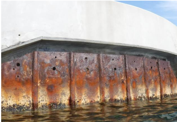
Corrosion généralisée des palplanches plates en tête
