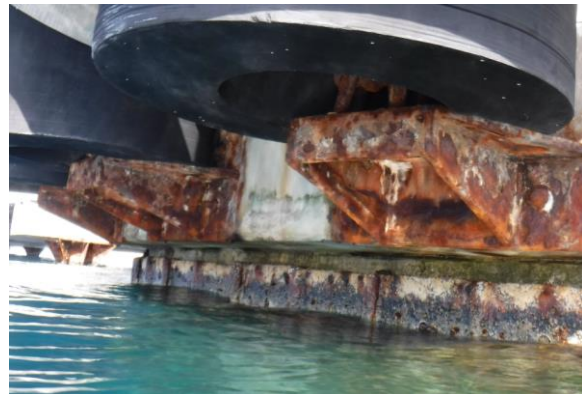
Corrosion des consoles supports (ducs d'Albe du poste de la ville)
