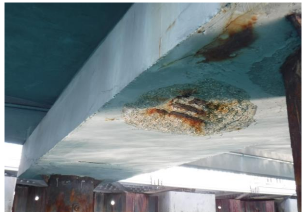
Poste N°1 – Eclat de béton sous chevêtre avec fers corrodés apparents (passerelle N°1)
