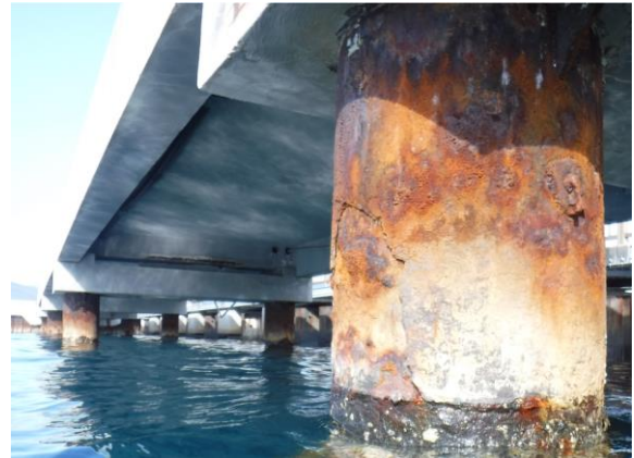
Corrosion généralisée des têtes de pieux
