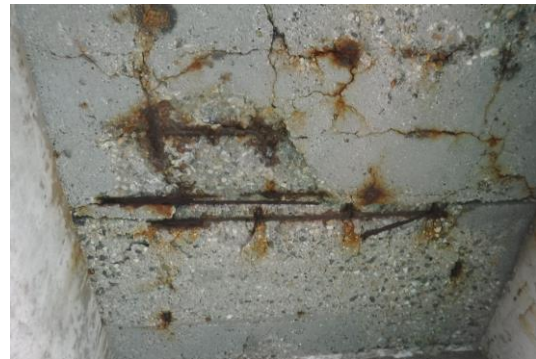
Désordres observés en intrados de la dalle de circulation
