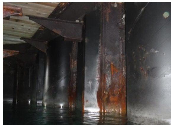
Zone de corrosion localisée à l'intérieur du duc d'Albe du poste N°3
